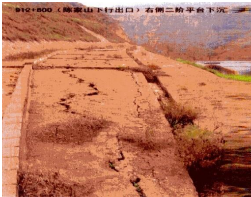
图 2.2-1 二级平台裂缝
